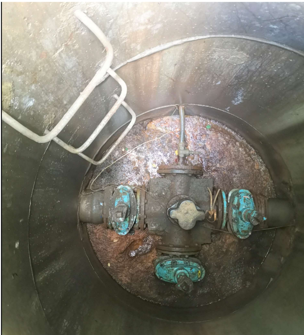
Bilde 1 Drikkevannskum nr 4234 på Sognshøy viser et nett med behov for rehabilitering.
